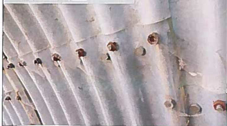
Lokálně chybějící spojovací šrouby.
