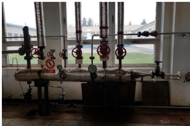
obr. rozvaděče páry v kotelně
