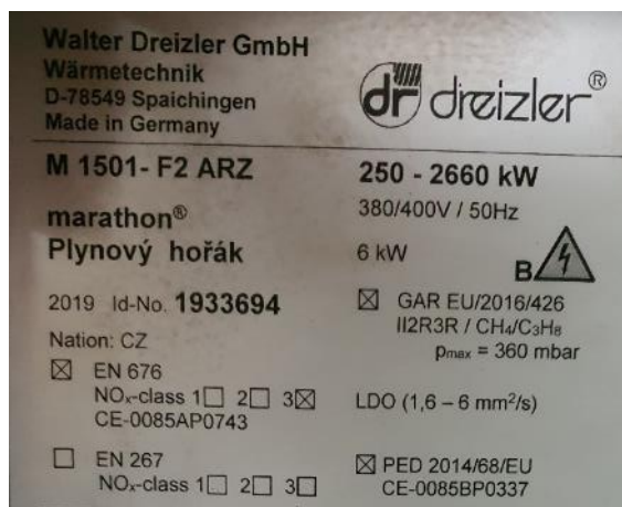
obr. štítek hořáku kotle K2
