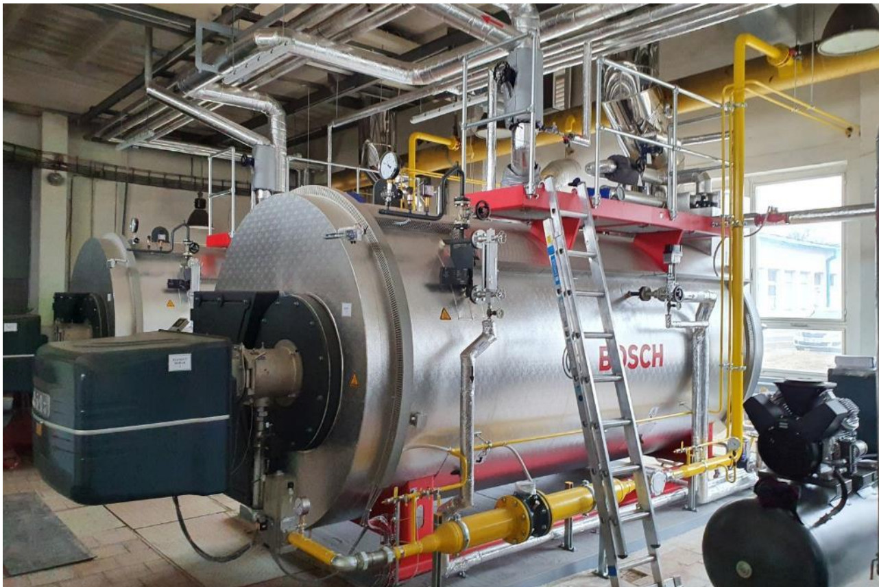
obr. parní plynová kotelna - celkový pohled obr. kotel K1, v pozadí K2
