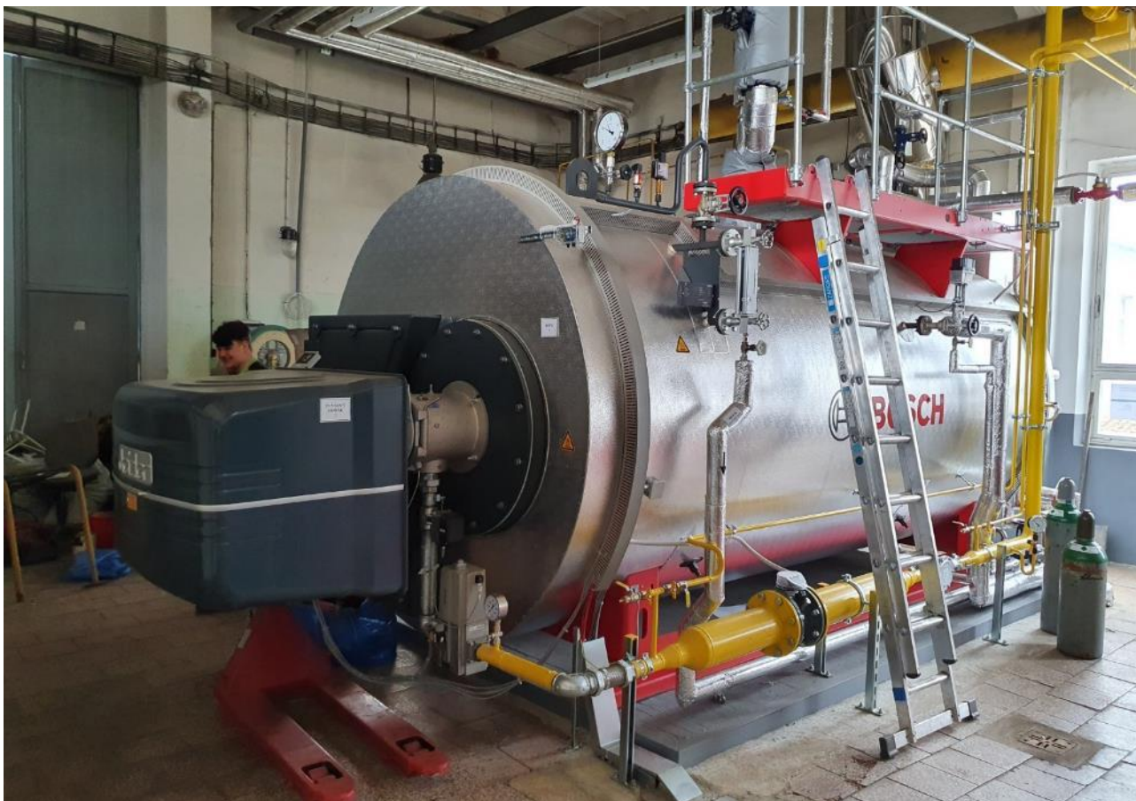
obr. parní plynová kotelna - kotel K2
